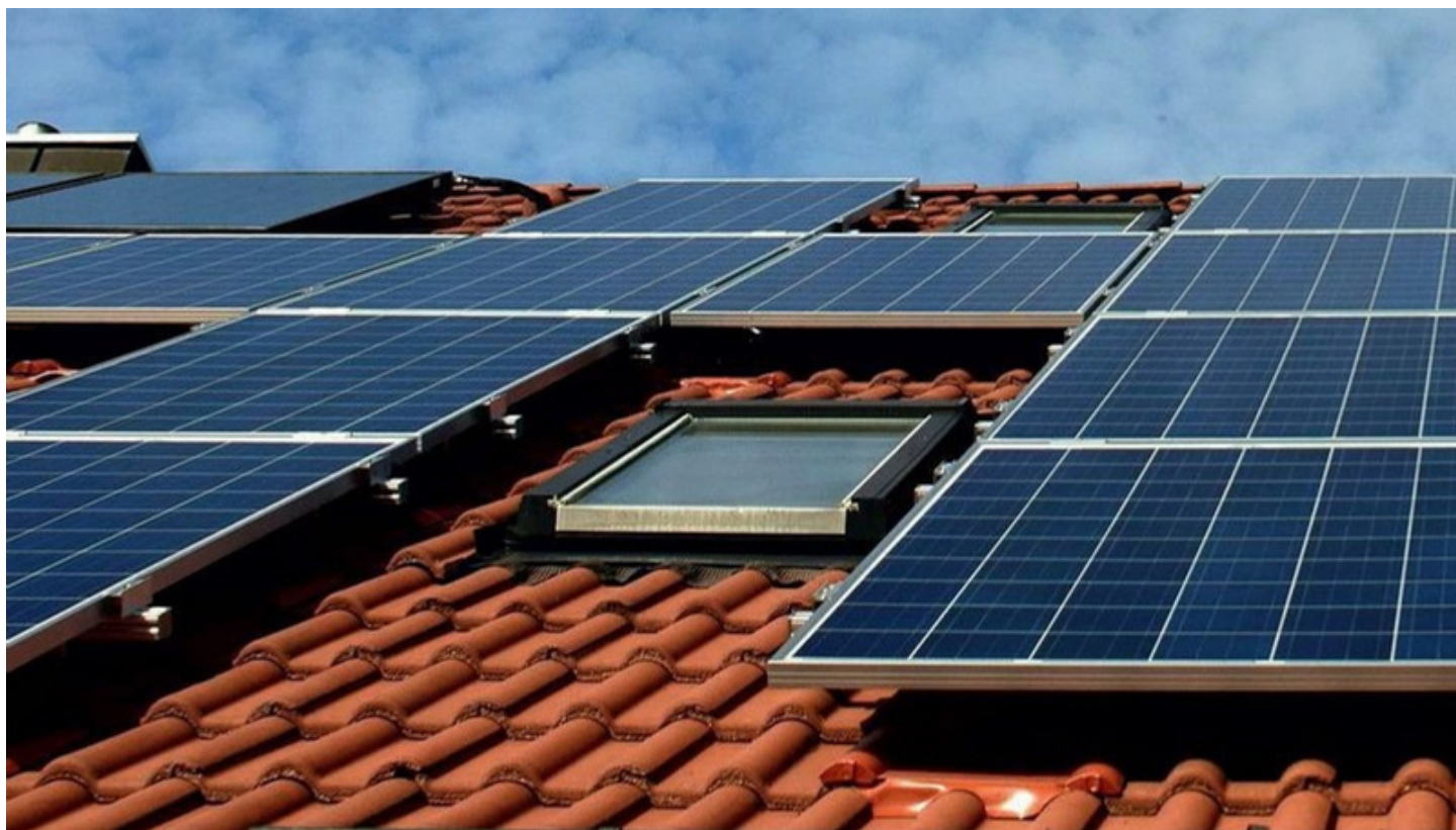
Figura 13 – Gli impianti fotovoltaici privati sono sovvenzionati dalla Provincia autonoma.
